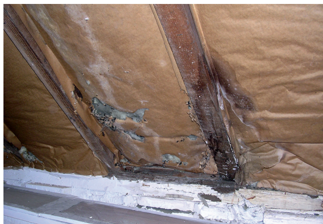
Verkeerd aangebrachte of isolatie in slechte staat verwijderen.
