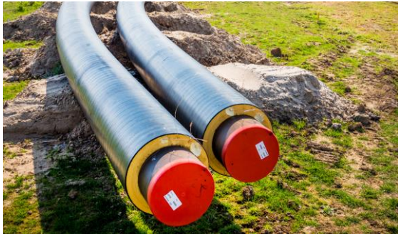
Warmtenetbuizen (bron Warmtenetwerk Vlaanderen)
