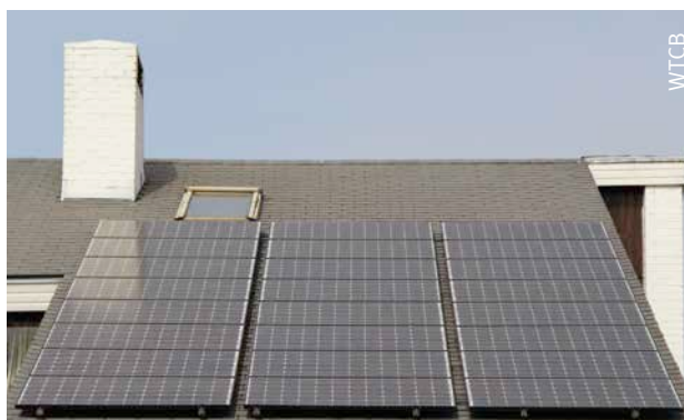
Afb. 3 Bovenop de dakbedekking geplaatste fotovoltaïsche panelen.
