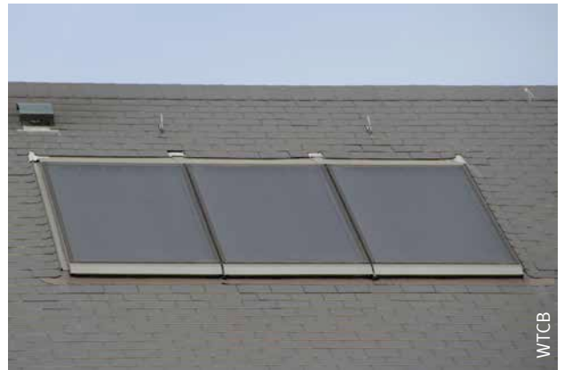
Afb. 7 In de dakbedekking geïntegreerde zonnecollectoren.
