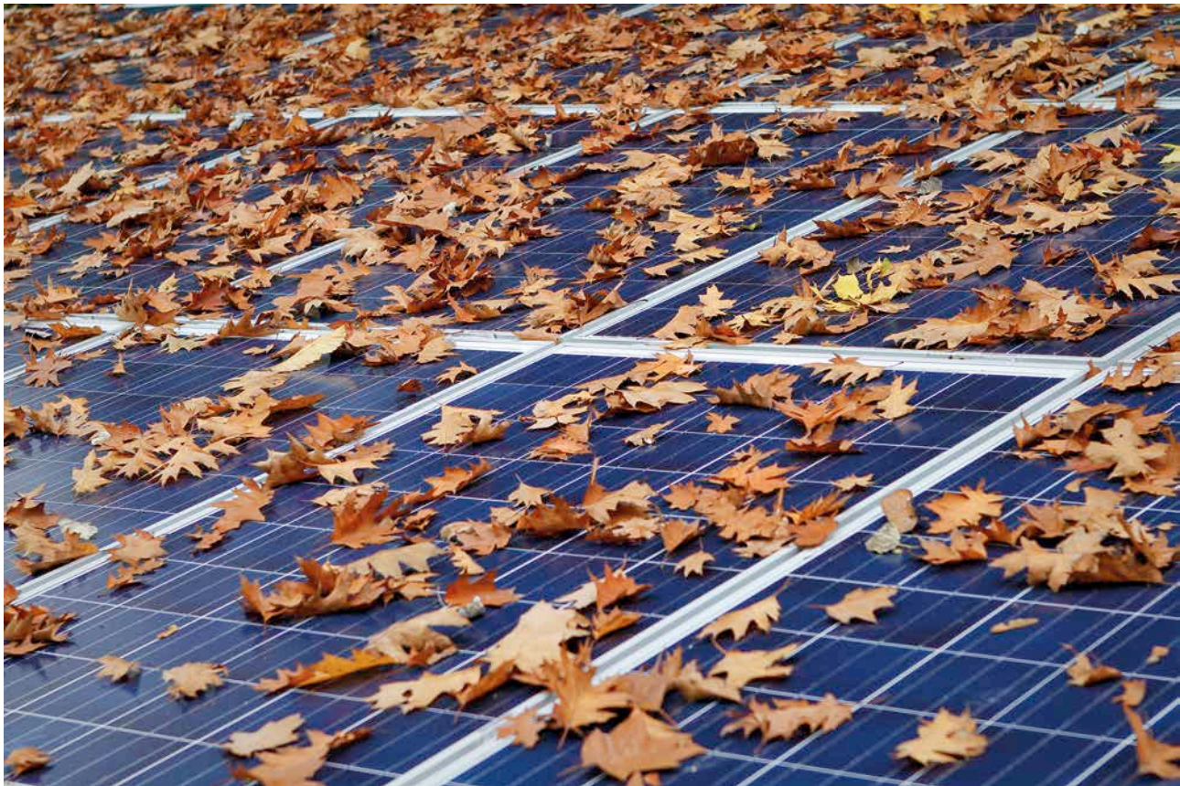
Afb. 54 Aanwezigheid van dode bladeren op fotovoltaïsche panelen.
