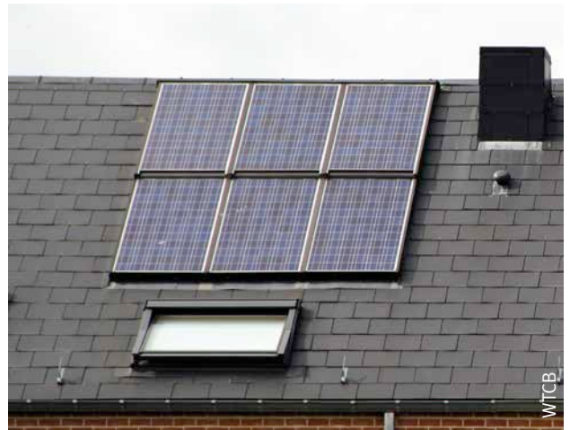
Afb. 6 In de dakbedekking geïntegreerde fotovoltaïsche panelen.
