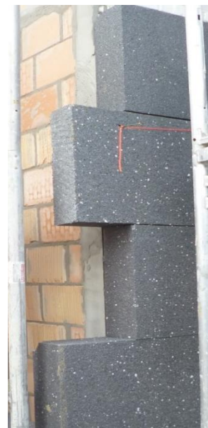
Isolatie geplaatst met verspringende voegen ter hoogte van de hoeken (foto: arch. D. Van Clé)
