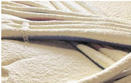
Niet geïsoleerde holle ruimte onder kruisende leidingen (afbeelding: Isolatie Verhoeven)
