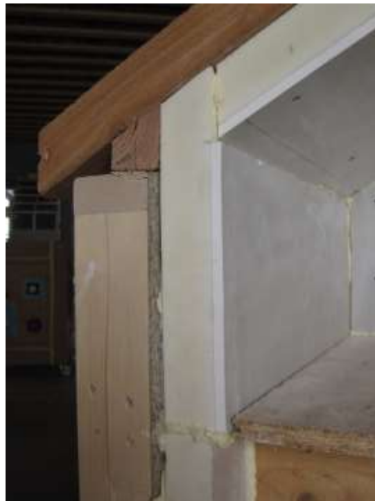
Afbeelding 149 : aansluiting binnenisolatie op dakisolatie van hetzelfde type (prefabpanelen); bemerkt dat de afwerkingsplaat van het wandpaneel verwijderd is ter hoogte van de aansluiting op de dakplaat; dit is praktisch eenvoudig en snel realiseerbaar en optimaliseert de continuïteit van de thermische isolatie
