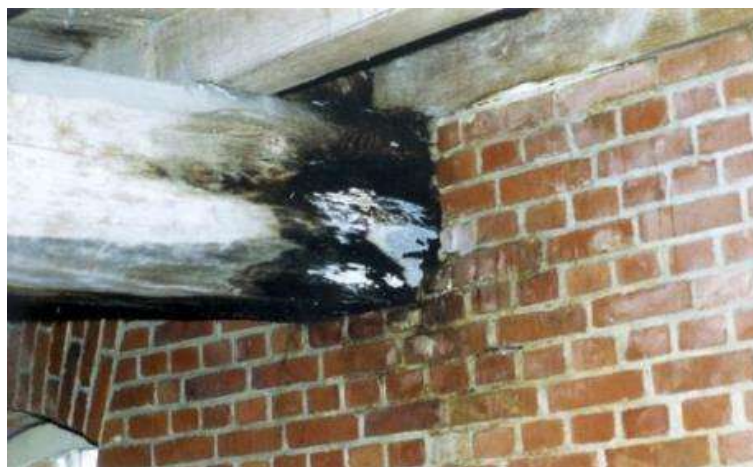
Afbeelding 4 : aantasting van een houten balkkop door houtrot [Bron: Meerselmolen.be]
