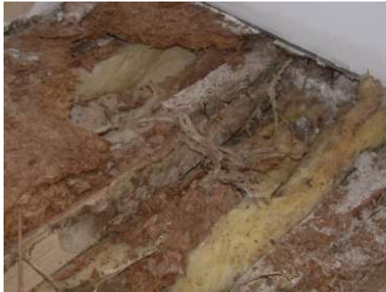
Afbeelding 3 : aantasting van een houten vloerbekleding door houtrot [foto WTCCB, L. Firket]
