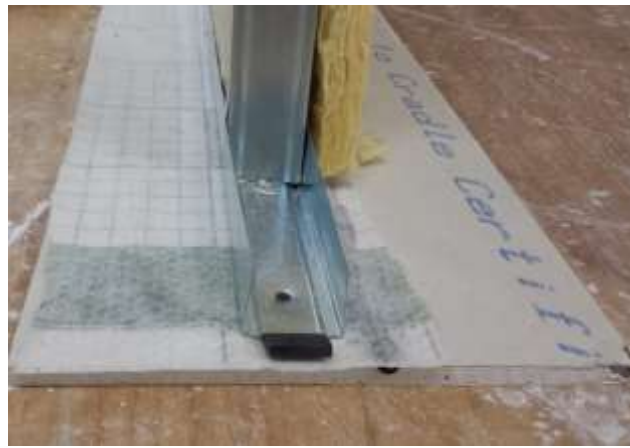
Afbeelding 51 : luchtdichte aansluiting op de vloer via een wachtfolie, luchtdicht verbonden op de vloer d.m.v. een kitvoeg
