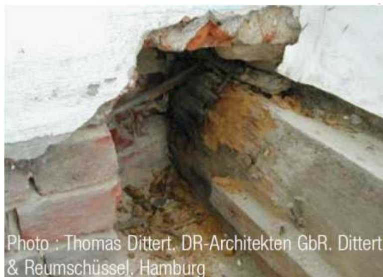
Afbeelding 96 : vloerbalk aangetast door houtrot na het aanbrengen van binnenisolatie [ref. Arch. Dittert, Hamburg]
