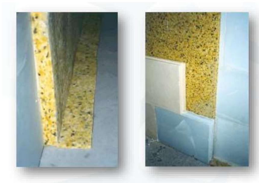
Afbeelding 59 : akoestische scheidingslaag tussen een binnenisolatiesysteem met capillair-actief materiaal en de bestaande muur en vloer (variante); periferisch soepele randstroken (aan de onderzijde en zijkanten van de muur, bovenaan kan opgespoten worden met – elastisch – montageschuim)
