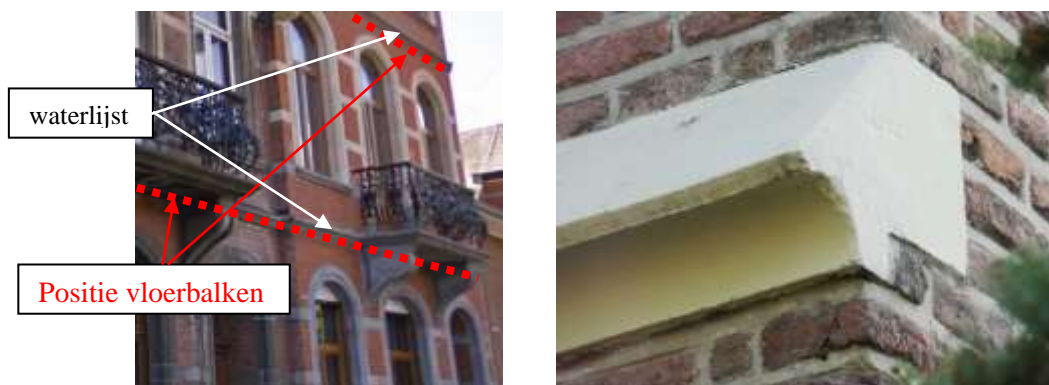
Afbeelding 103 : waterlijsten met afgeschuind bovenvlak en druiplijst kunnen de vochtbelasting op houten balkkoppen reduceren [ref. foto rechts: http://www.documentatie.org/B/B----/B---w/Waterlijst.htm ]
