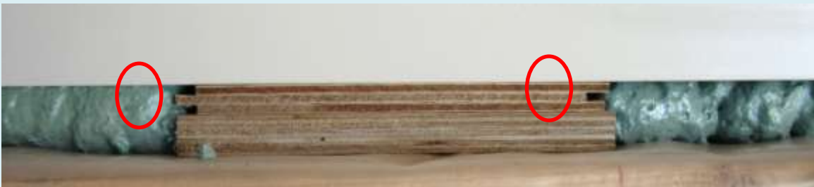
Afbeelding 27 : interactie tussen gespoten PUR-schuim en stelblokjes kan aanleiding geven tot kleine luchtlekken
