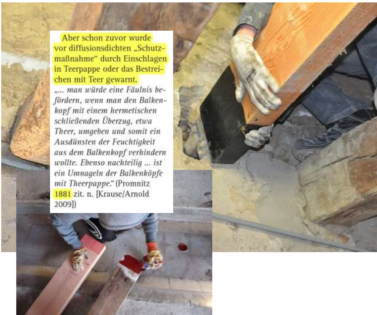
Afbeelding 100 : al in de 19de eeuw werd gewaarschuwd dat dampdichte behandelingen van balkkoppen (op basis van teer bv.) aanleiding kunnen geven tot houtrot, omdat de balkkoppen niet meer kunnen uitdrogen
