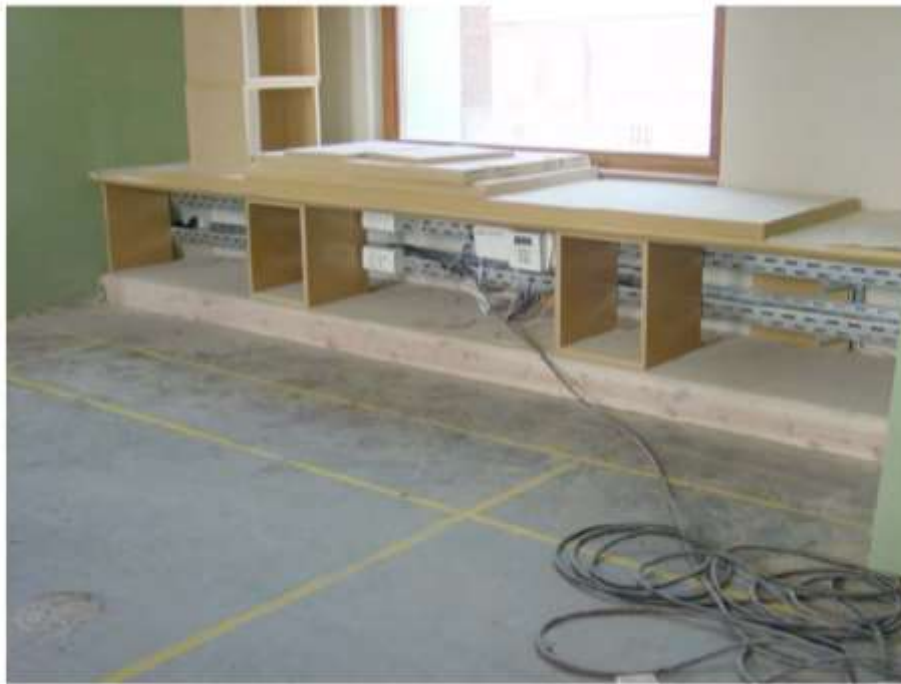
Afbeelding 80 : voorbeeld van combinatie van retourisolatie aan de bovenzijden van een verdiepingsvloer in beton met vast meubilair (en een horizontale leidingkoker in opbouw) [ref. Presentatie IsoproC, "Isoleer uw buitenmuren!", 27.05.2009]
