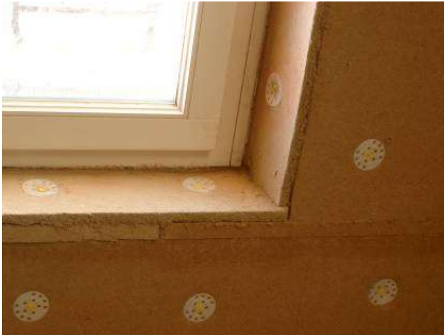
Afbeelding 176 : praktijkvoorbeeld van een raamaansluiting met binnenisolatie op basis van houtvezelplaten [ref. KRONOS architectuur, 2006]
