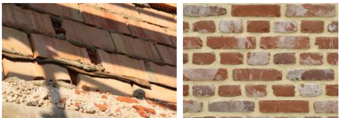
Afbeelding 110 : de luchtdichting van de muur wordt sterk bepaald door de kwaliteit van het metsel- en voegwerk; voorbeeld van een voor de beperking van het schaderisico ter hoogte van de balkkoppen bij binnenisolatie onvoldoende luchtdichte muur (links [foto WTCB]) en een voldoende luchtdichte muur (rechts) [ref. Vandemoortel] (vermoedelijk, op basis van visuele controle; een pressurisatietest met lekdetectie kan meer duidelijkheid bieden)
