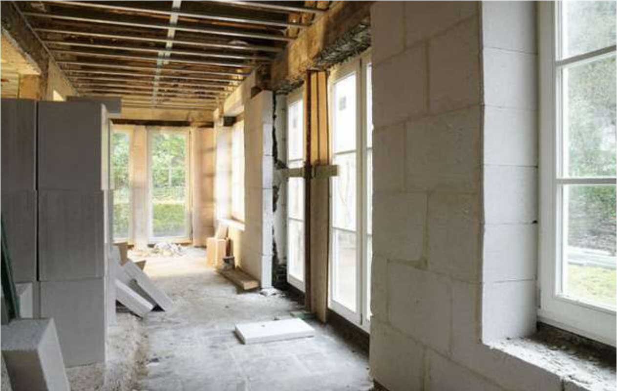
Afbeelding 183 : praktijkvoorbeeld van een raamaansluiting met binnenisolatie op basis van lichte cellenbeton [ref. Xella]
