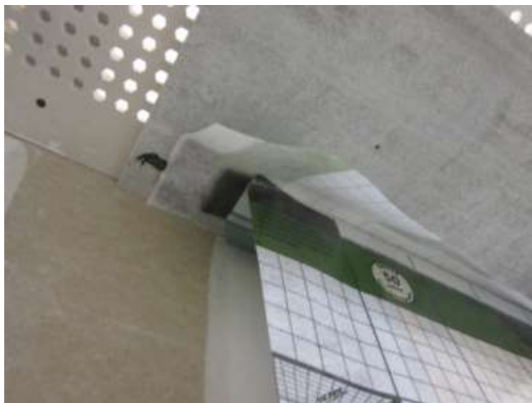
Afbeelding 89 : aansluiting binnenisolatie – massieve verdiepingsvloer, aan de bovenzijde (plafond); stijl- en regelwerk in metalstud, luchtdichte aansluiting van het luchtscherm tegen de onderzijde van de vloer d.m.v. een kit, in het vlak van de binnenisolatie, m.b.v. een wachtfolie
