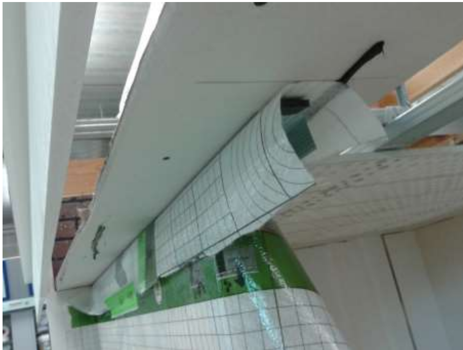
Afbeelding 91 : aansluiting binnenisolatie – massieve verdiepingsvloer, aan de bovenzijde (plafond); stijl- en regelwerk in metalstud, luchtdichte aansluiting van het luchtscherm tegen de onderzijde van de vloer d.m.v. een kit, aan de achterzijde van de binnenisolatie, m.b.v. een wachtfolie; aansluiting van de wachtfolie op het luchtscherm d.m.v. luchtdichtingstape
