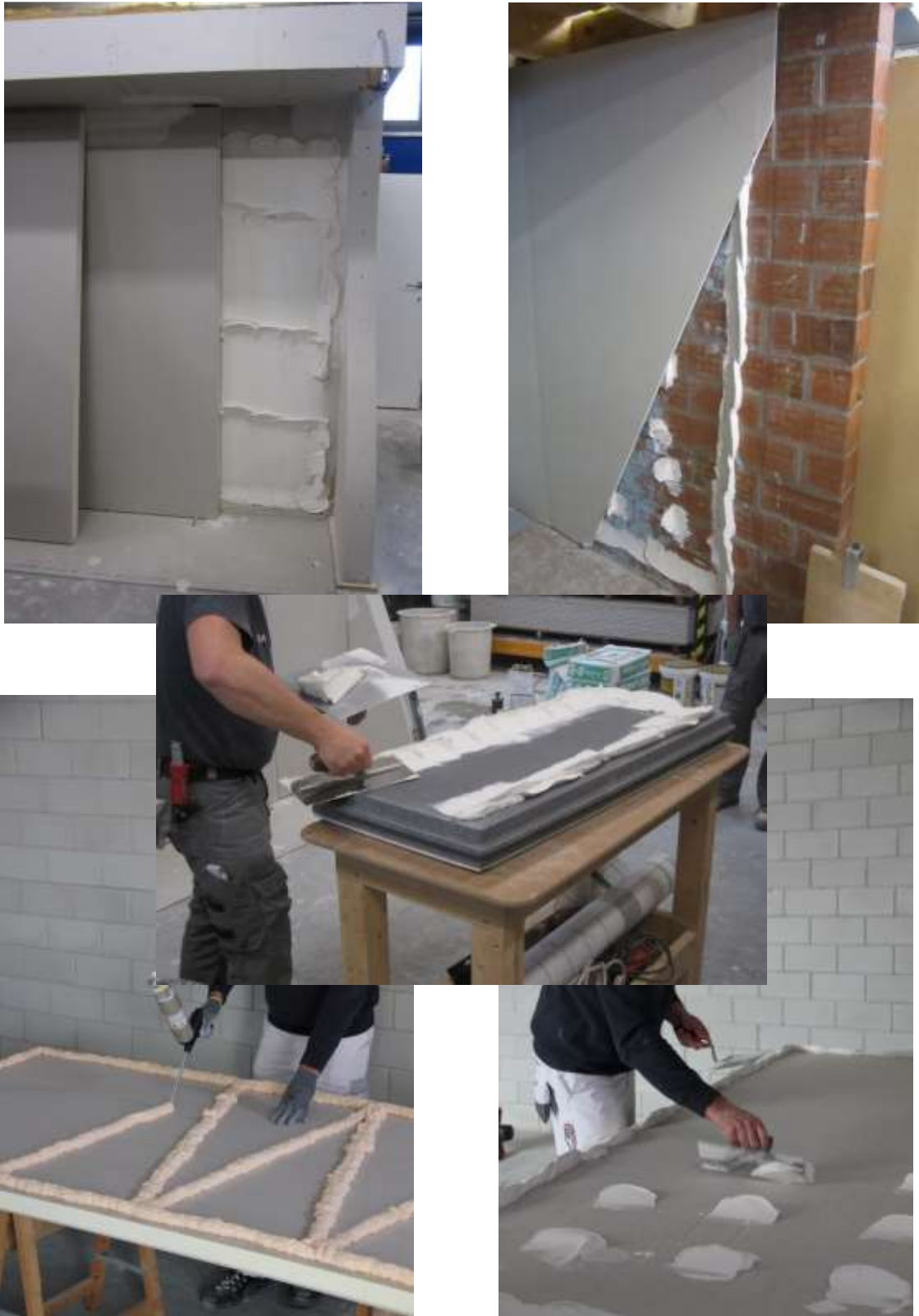
Afbeelding 19 : de manier waarop prefab platen verkleefd worden op de ondergrond heeft een belangrijke invloed op het al dan niet voorkomen van schimmelvorming en/of oppervlaktecondensatie tussen de platen en de muur; verschillende varianten zijn mogelijk; essentieel is dat luchtstromen tussen plaat en muur zoveel mogelijk gereduceerd worden door een voldoende compartimentering
