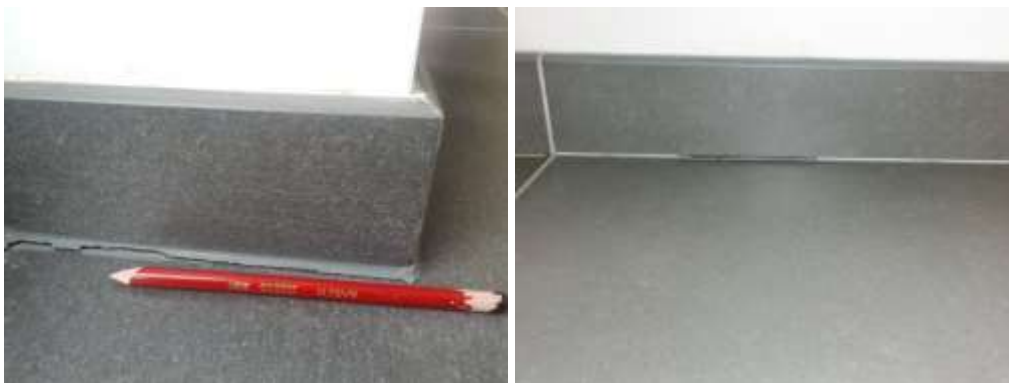
Afbeelding 44 : voorbeelden van losgekomen siliconevoegen (ref. Bouwinfo.be)
