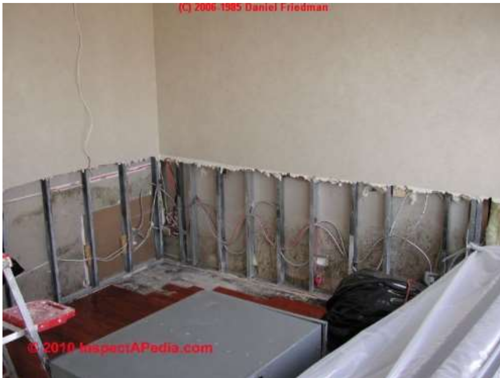
Afbeelding 2 : schimmelgroei achter een wandbekleding [bron: https://www.epa.gov/mold/mold-image-library ]
