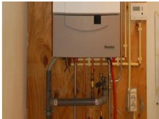
Condensafvoer (links) en afvoer overdrukventiel voor sanitair warm water (rechts)
