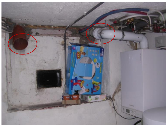
Open geïnstalleerde gesloten ketel met luchttoevoeropening Foto : Dialoog vzw
