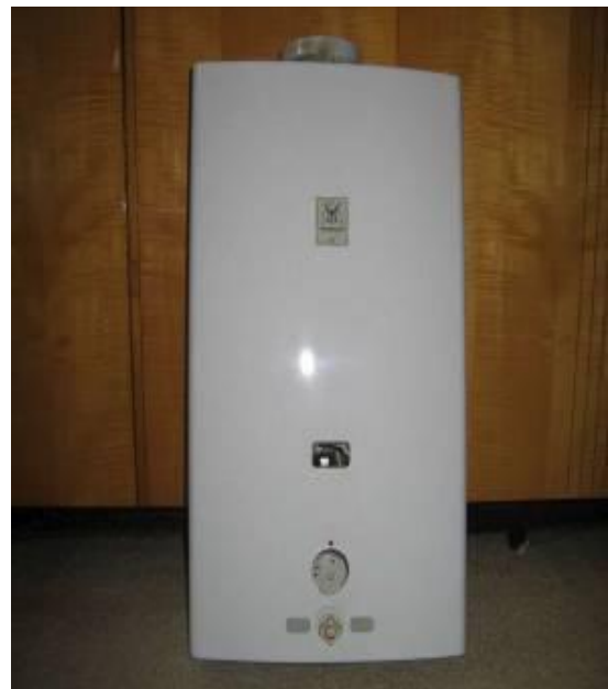
Doorstromer op gas Foto: Inspectieprotocol energieprestatiecertificaat bestaande gebouwen met woonfunctie, VEA
