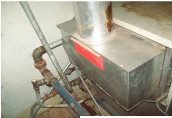
Chaudière à gaz naturel
