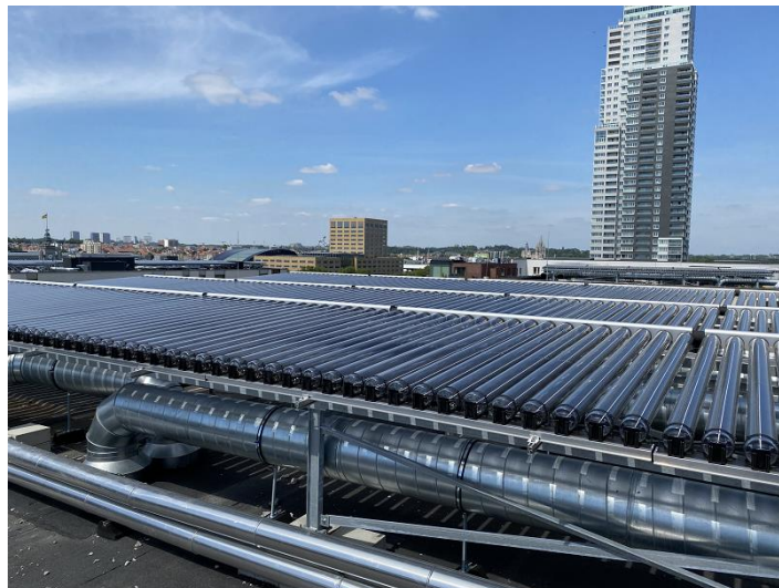
Figuur 43 Toepassing van een zonneboilerinstallatie (bron: eigen archief Ingenium)
