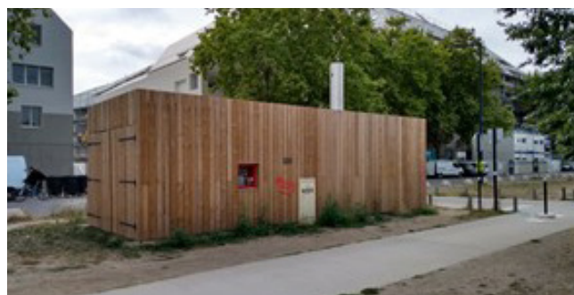
Voorbeeld tijdelijke stookinstallatie op aardgas (Bordeaux Rive Droite)
